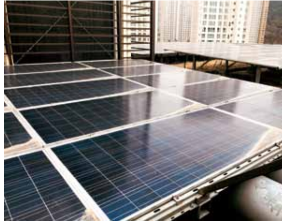
건축물 옥상에 설치된 태양광 발전 설비
