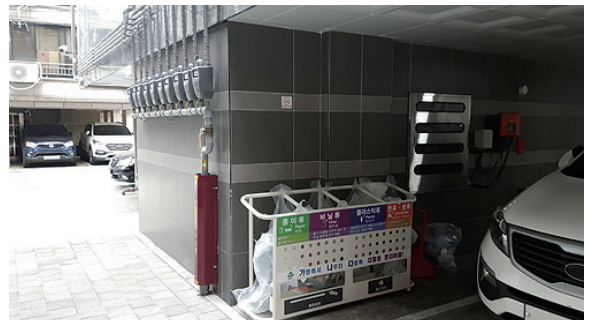
검침용 기기(세대 외부에 설치)
